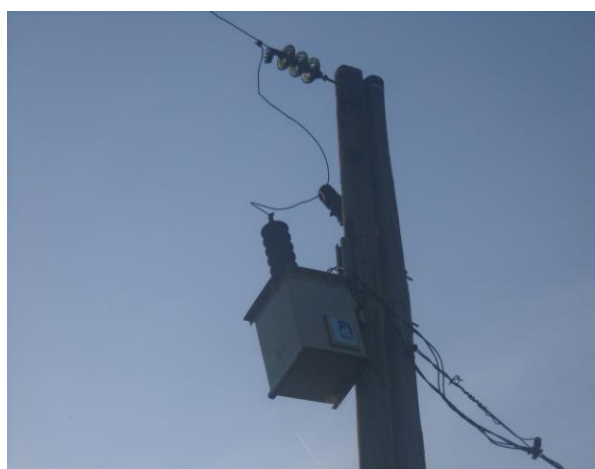
Photo 10: Transformateur du village Nkout
