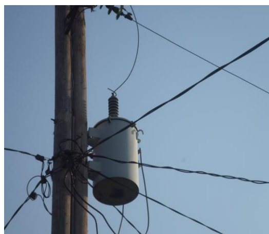
Photo 11: Transformateur du village Kondémeyos
